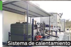
Sistema de calentamiento
